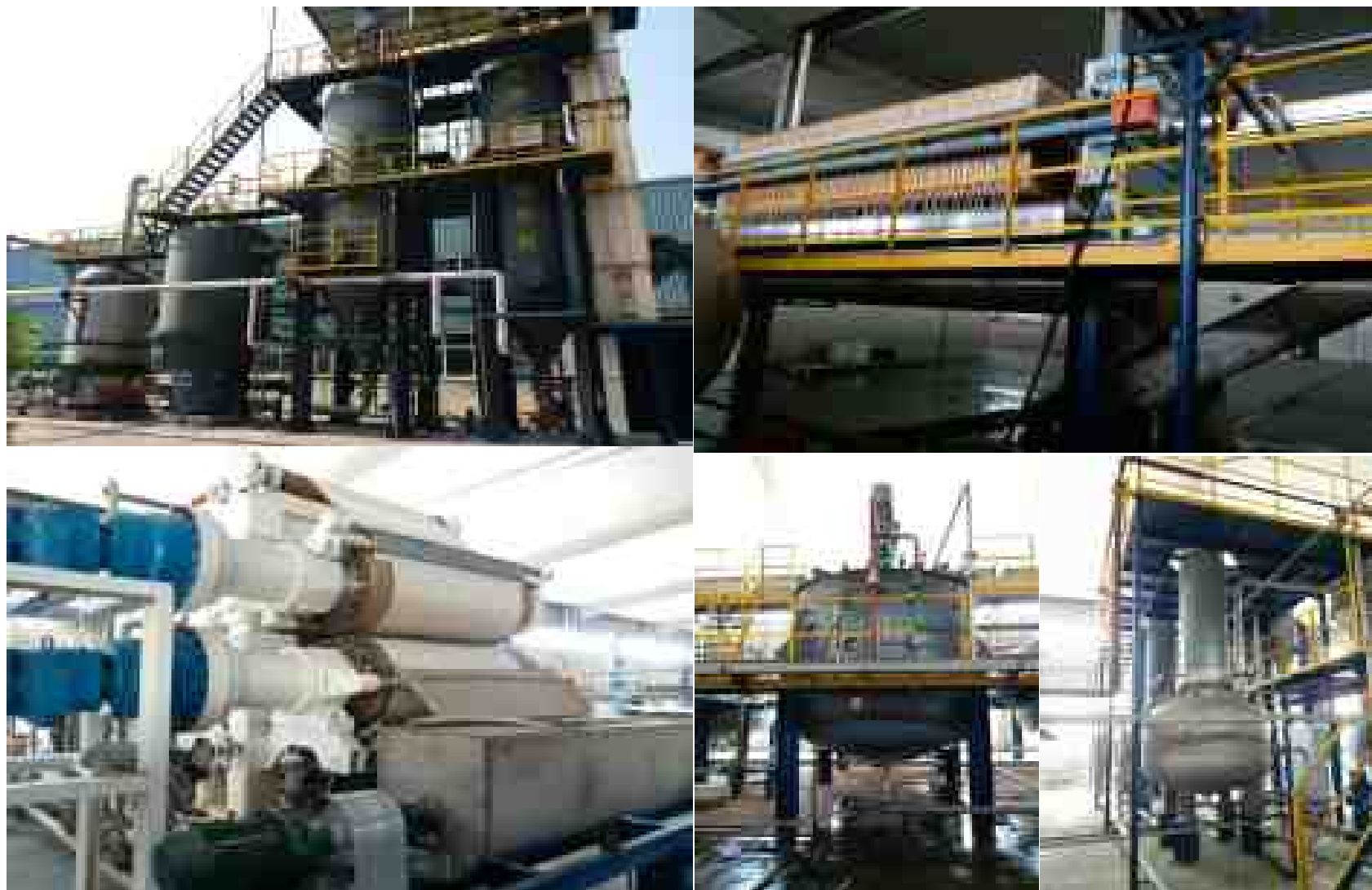
万吨级中试工程设备
